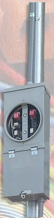
RTABLERO1 TABLERO Armado 110V
