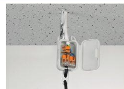
Conexión de lámpara en falso techo
