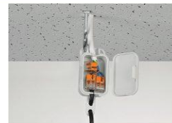
Conexión de lámpara en falso techo
