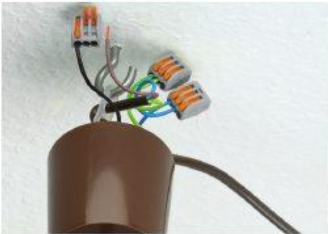
Conexión de elemento de iluminación con conductores flexibles y alimentación de corriente
